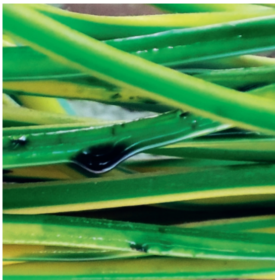
20 | Sostanze nocive nei vecchi cavi Attenzione alla sicurezza durante lo smontaggio
