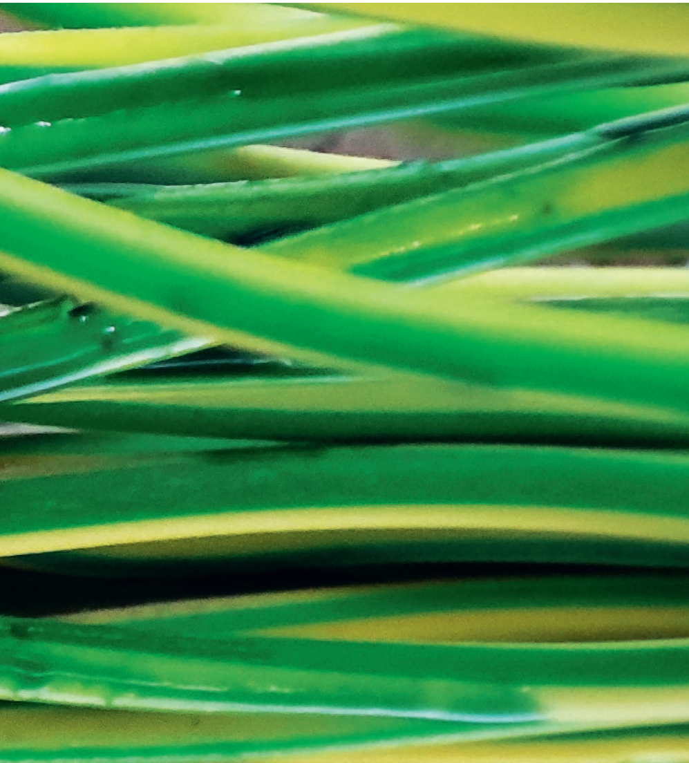
Perdita di massa verde dai fili del conduttore di protezione al morsetto in un quadro di distribuzione del 1975 (immagine d'archivio Kaspar Belser Elektroplanung)
